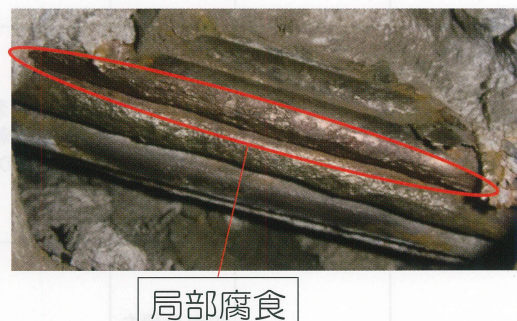
図-18 A1側上縁定着④上側鋼材腐食状況
