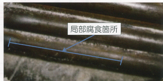
写真-4 M 橋 A1 側の上縁定着②のケーブルの下側削孔箇所の下側 PC 鋼線の局部腐食の様子
