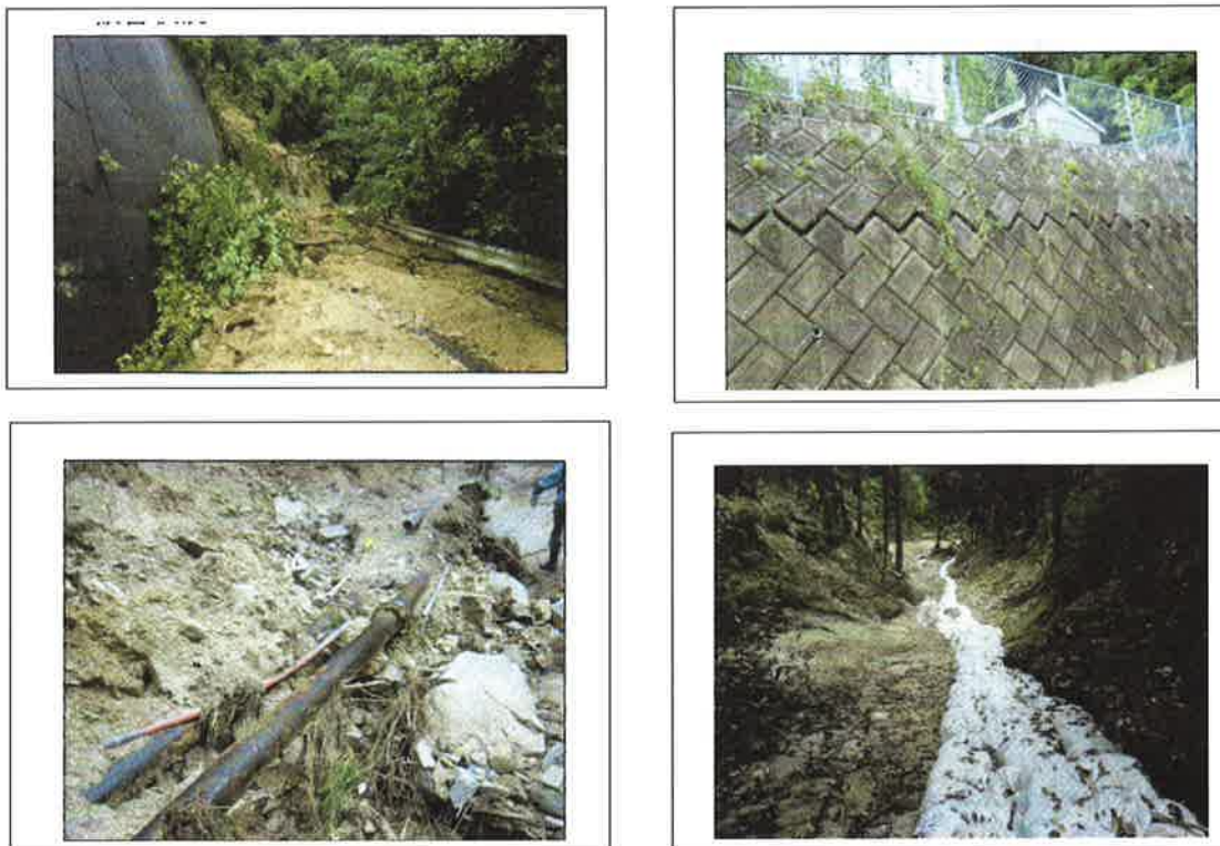
図2-3 法面崩壊による土砂堆積、擁壁クラック、管路露出、仮復旧の様子
