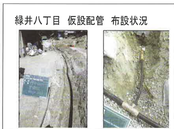
図 2-10 仮配管に使用された黒 PP パイプ
