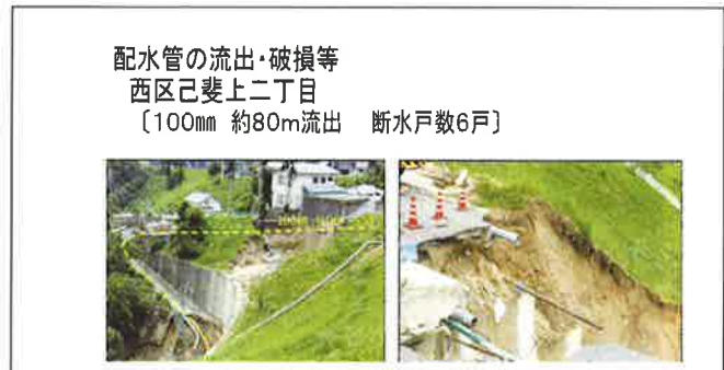
図 2-4 西区己斐の管路の露出
