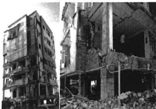
図-5.6 RC ビルの倒壊
