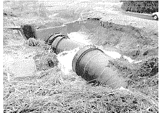
図-2. 大口径管の破損(宮城県企業局提供 1) )
