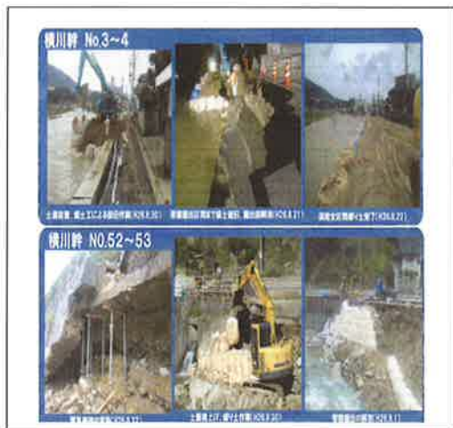
図-20 横川幹線の被害と修復
