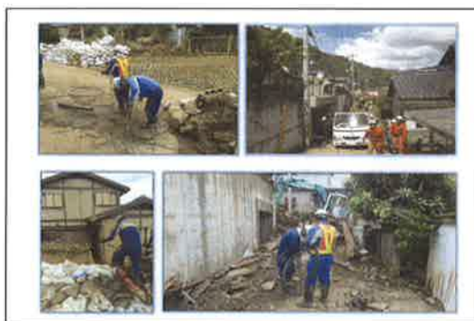
図-22 ユーザー系の被災と復旧
