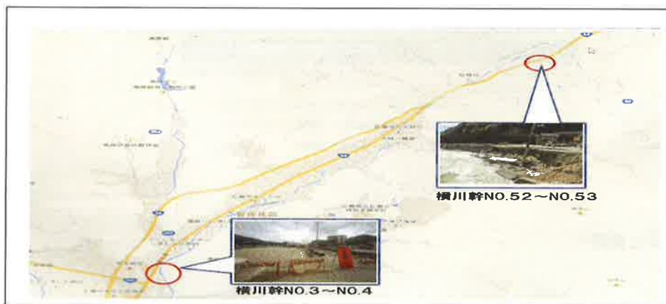
図-18 横川幹線中継ケーブルにおける道路法面崩落位置での垂れ下がり
