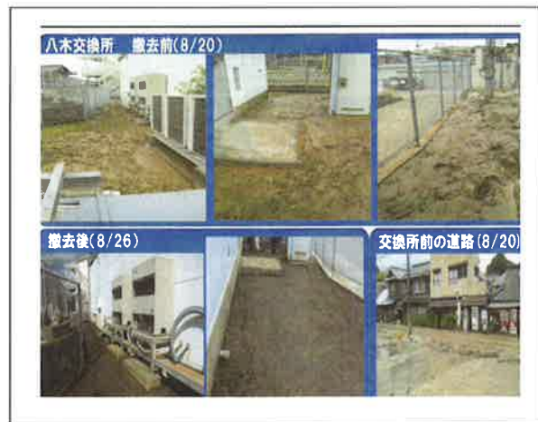
図-21 八木交換所への土砂流入と撤去
