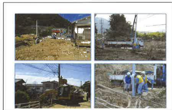
図-23 配線系（電柱）の被災と復旧
